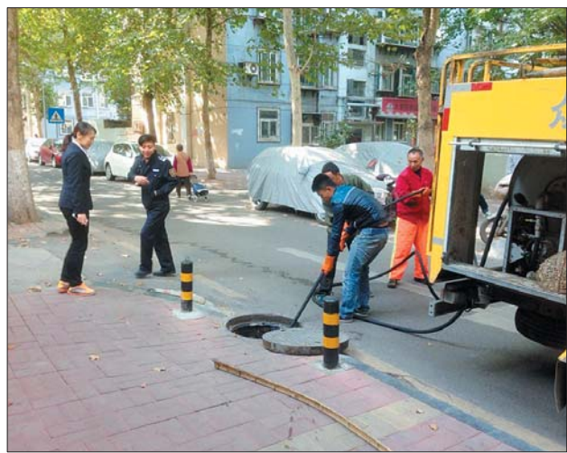
下水道堵了,四居赶紧联系清理。 本报记者 林媛媛 摄
