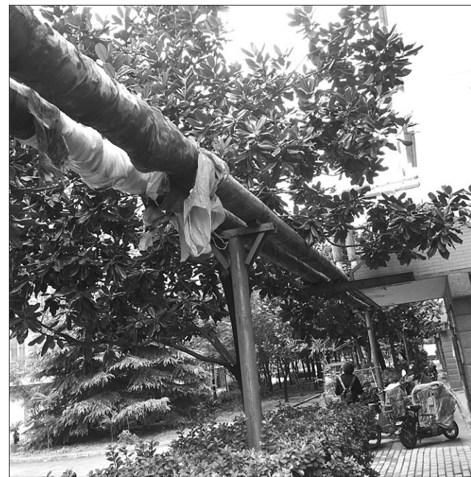
被割开的供热管道至今漏水。本报记者 庄子帆 摄
