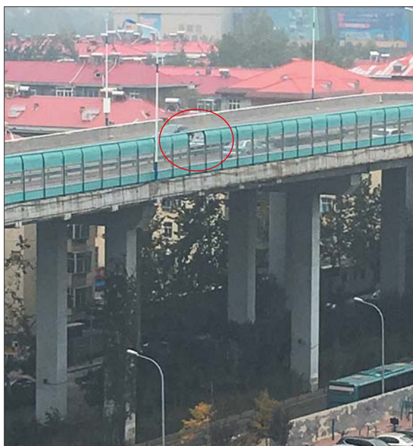
事发高架桥,其中有一块隔音板空缺。 本报记者 戚云雷 实习生 揭丁诺 摄
