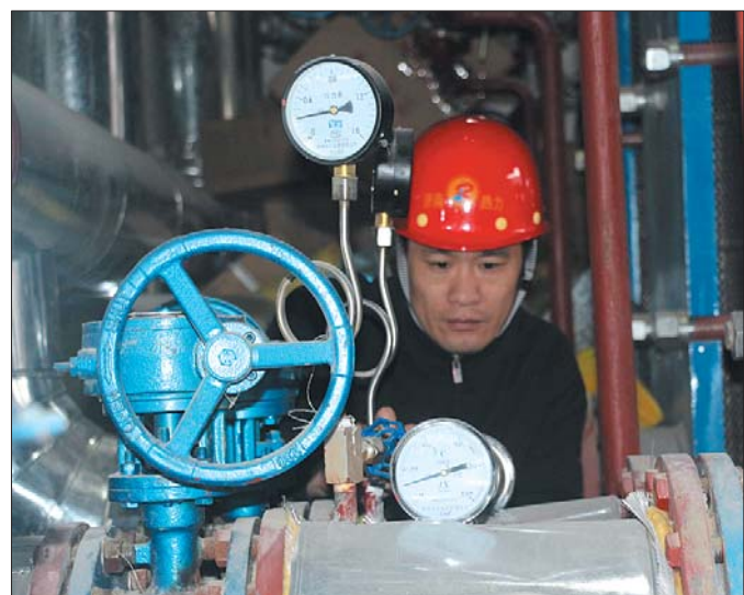
万科城换热站正在调试。 本报记者 蒋龙 通讯员 秦青 摄
