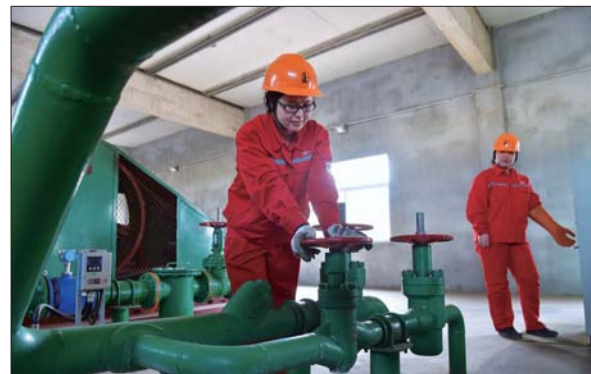
桩106注水站职工正在进行起泵工作。
