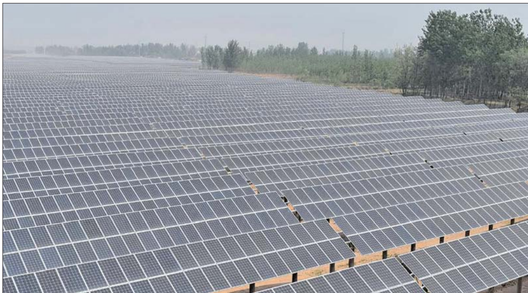
怀仁的地面光伏发电设备。
