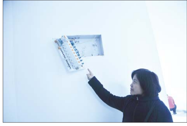
王女士家电闸被掀开,里面的电线都没了。
