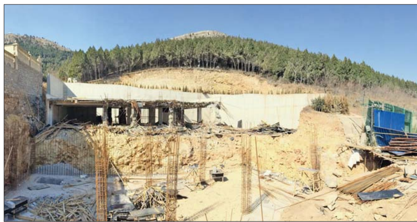
中海别墅区内前期被强拆过的开挖山体违建,目前仍未恢复。
