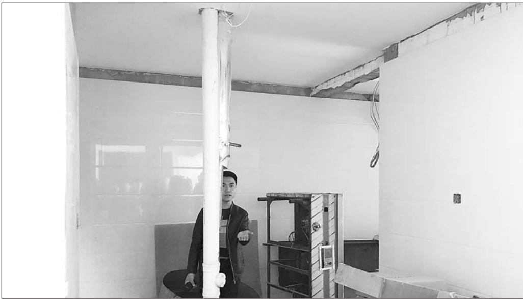
小区物业的高经理称,消防喷淋管道已被饭店擅自改动。
