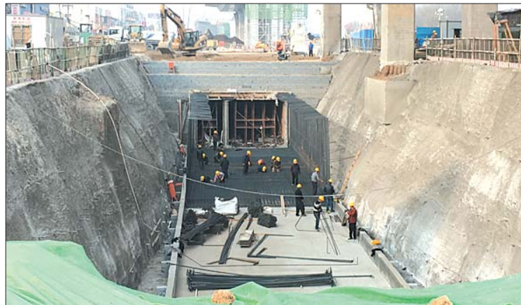
工业北路快速路的地下综合管廊建设正在加速推进。 本报记者 王皇 摄
