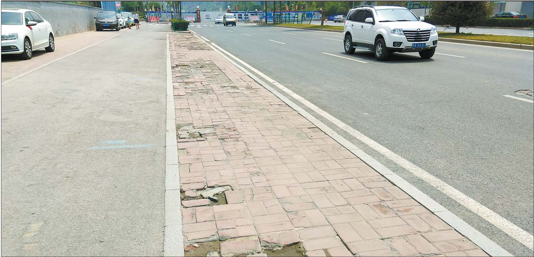
奥体西路人行道花砖破损严重,省城部分主要街道人行道都出现了类似情况。
