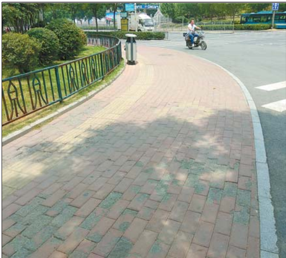
奥体中路坤顺路花砖损坏严重。
