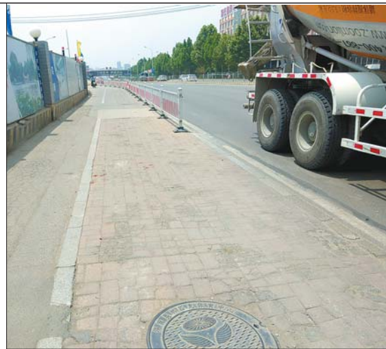
工业南路和奥体西路路口花砖损坏严重。
