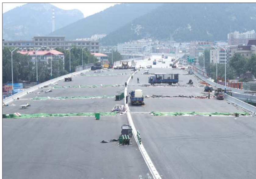
作为二环东路南延项目的桥头堡,经过一年多的施工,燕山立交桥南侧铺设沥青,计划月底恢复匝道交通。 本报记者 刘飞跃 摄
