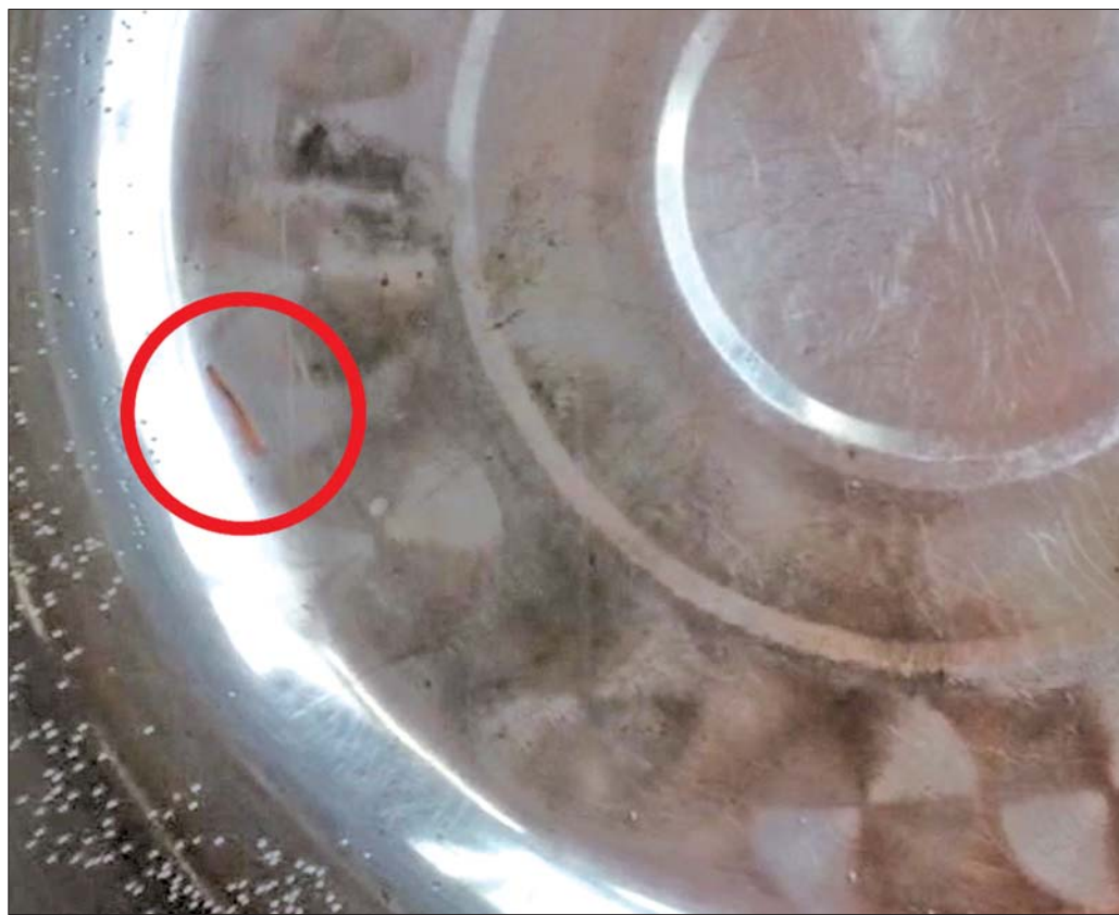
凤凰山庄小区居民家中供水管道里流出的红色线虫。
