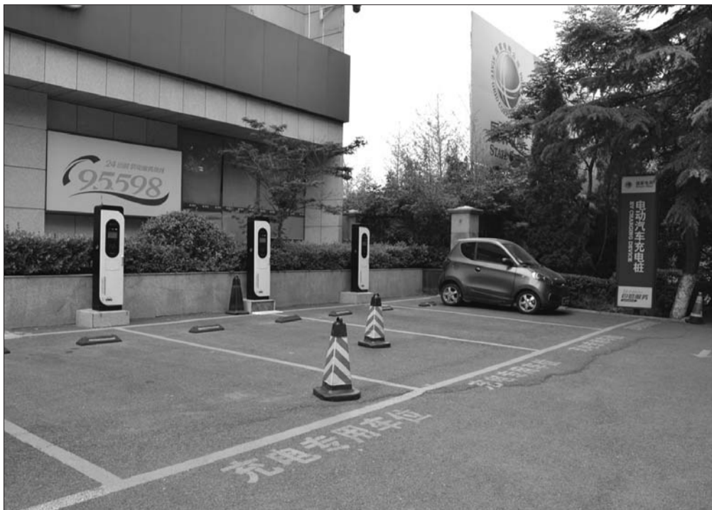
城区火炬路上投入使用的充电桩。 本报见习记者 孙璇 摄
