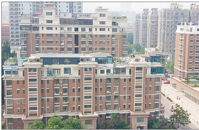
20号楼楼顶上盖着多座违建。
