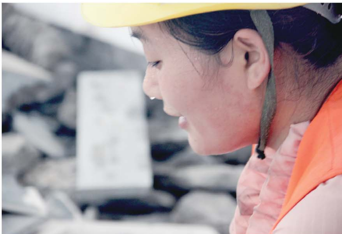
在不透气的工地内,几锹下来,段金枝的脸上已满是汗水,她顾不上擦汗,汗水一滴滴落在脚下。
