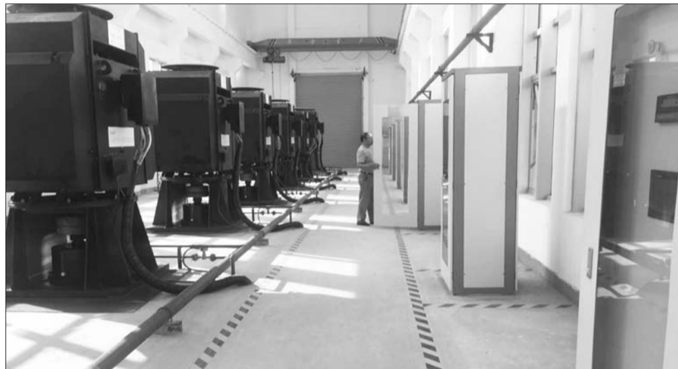
3#泵站内共有12台水泵。
