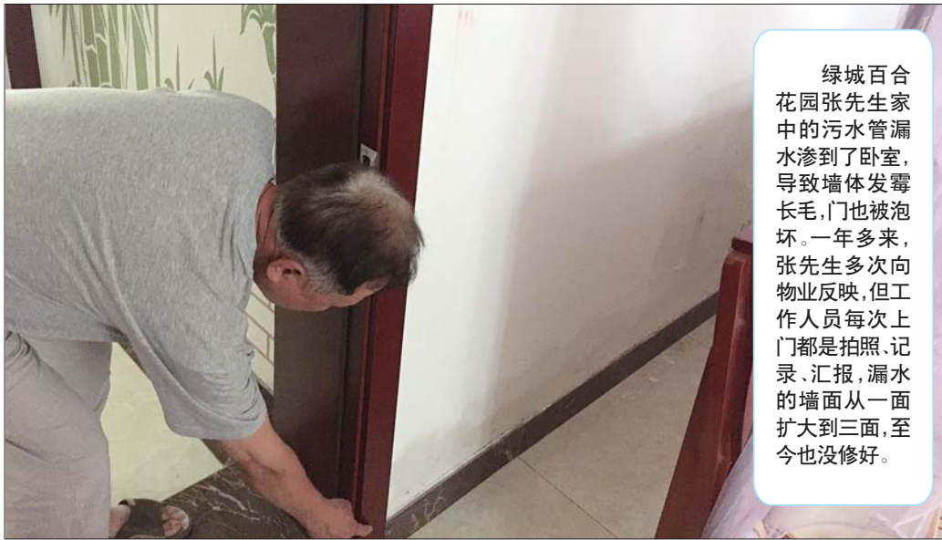
由于长期渗水,张先生家卧室一面墙的墙皮已脱落,还长了毛。
