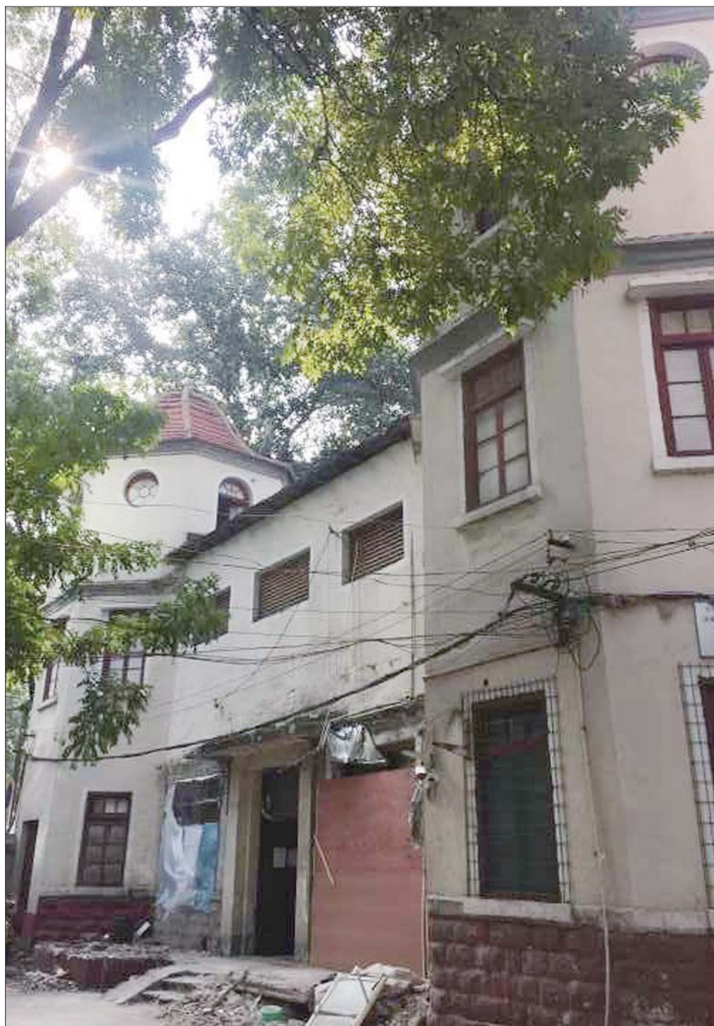
德国诊所旧址文物楼外建筑垃圾遍地,原本漂亮的楼体如今看上去破败不堪。
