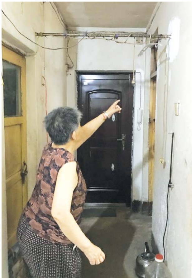
在闫奶奶家中，几根电线缠绕在一起，形成安全隐患。 本报记者 陈玮 摄
