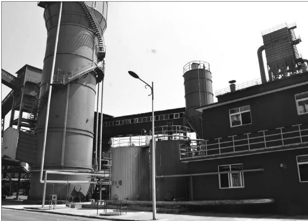
兖矿国际焦化公司烟气脱硫装置。
