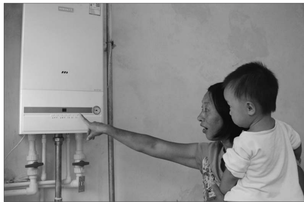
居民家中安了燃气壁挂炉。本报记者 孙璇 摄。
