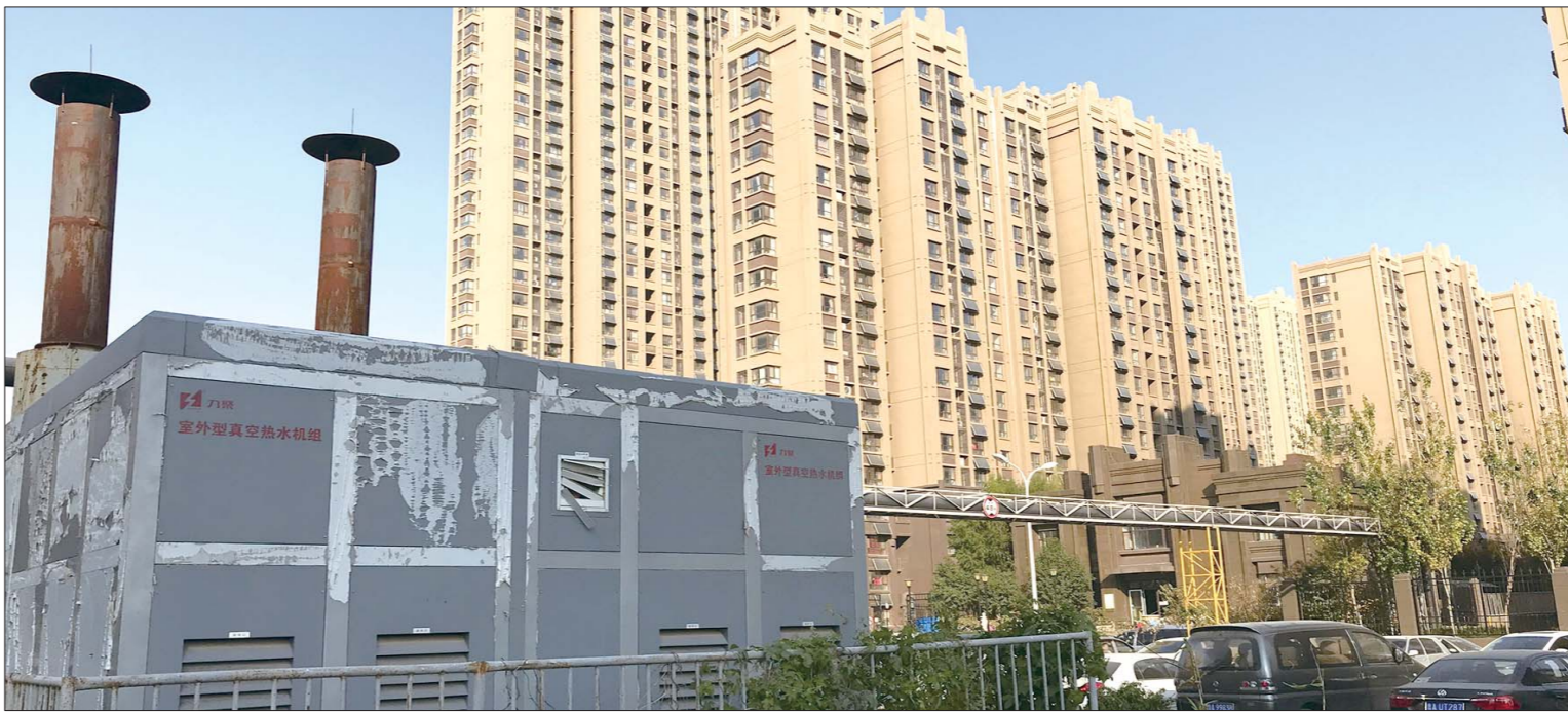
绿地泉景园小区自用的锅炉供暖设备。 本报记者 王杰 摄
