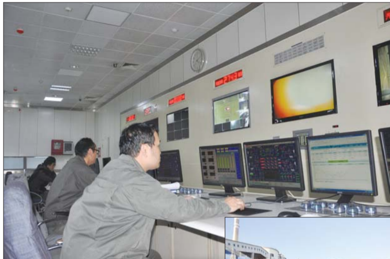
▲ 供热管网已经完成升压试运营。
