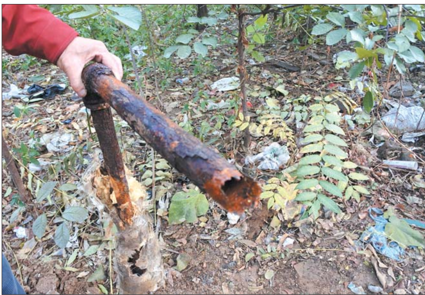
省城一些小区内部陈旧的管网影响了供暖,需产权单位配合改造。(资料片) 本报记者 蒋龙龙 摄
