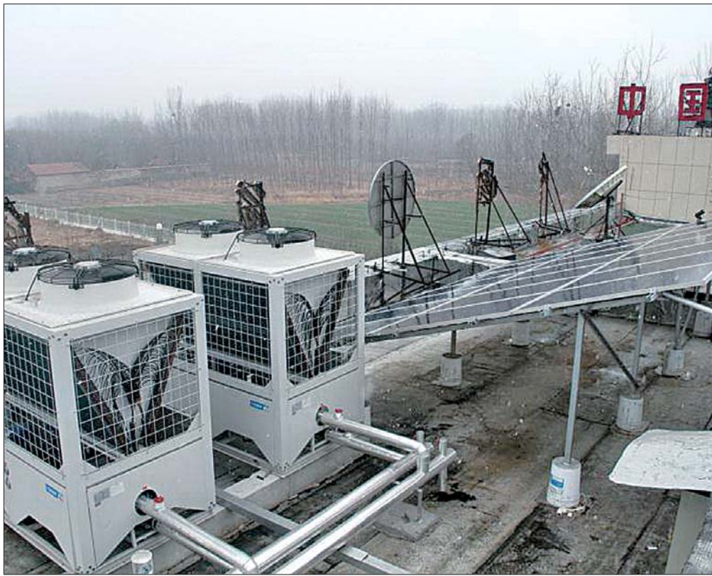
空气源热泵配套光伏发电,彻底实现了节能环保。 本报记者 李凌云 摄
