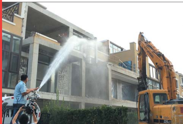
▲工作人员拆除东方美郡别墅区违建。(资料片) 本报记者 张阿凤 摄
