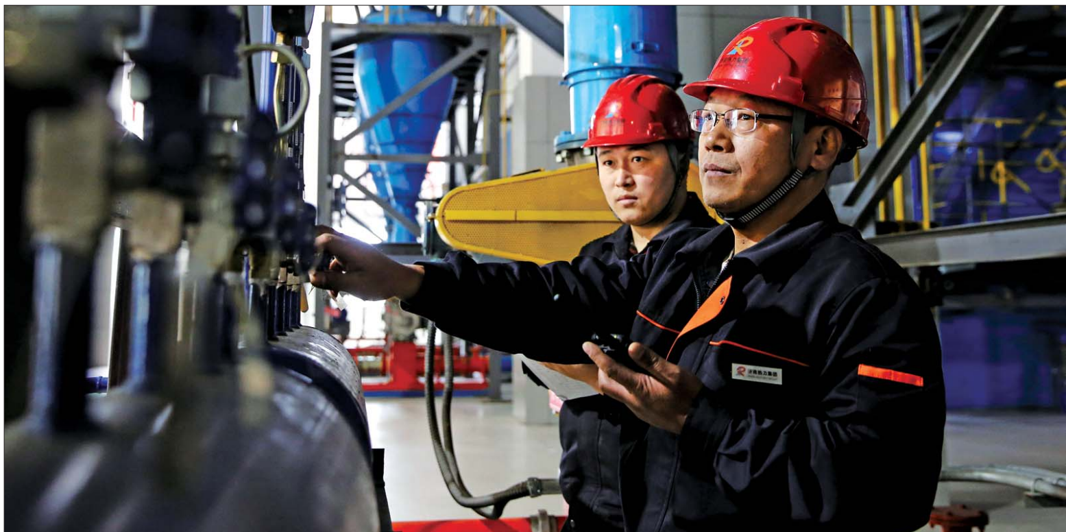
热力集团员工正在进行设备巡检。
