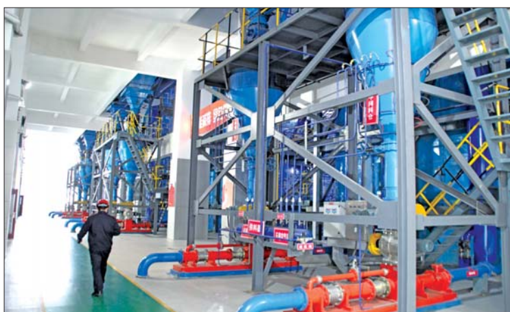
济南热力集团已全面完成超低排放改造——浆水泉供热公司。 济南热力供图
