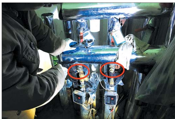
有居民违规将原装的闭锁阀门(右)拆除，更换上可任意开关的阀门(左)。 本报记者 张帅 摄
