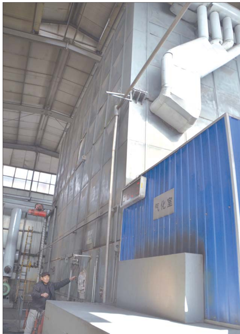
图为金丝达集团改造成功的无烟锅炉。煤炭通过蓝色的气化室气化后再燃烧,可以降低烟尘排放量。本报记者 高寒 摄
