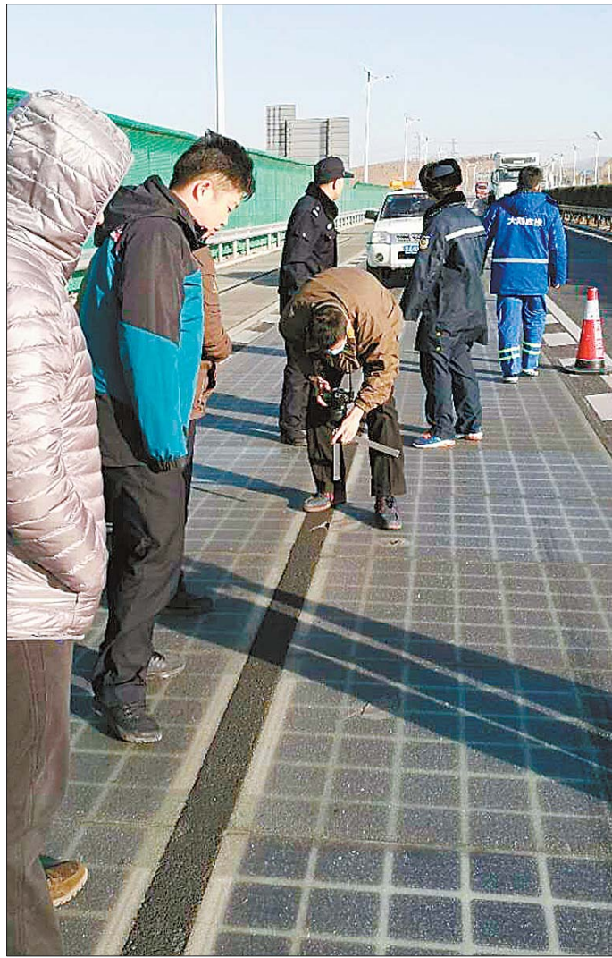
警方在勘察光伏路面受损情况。 济南警方供图
