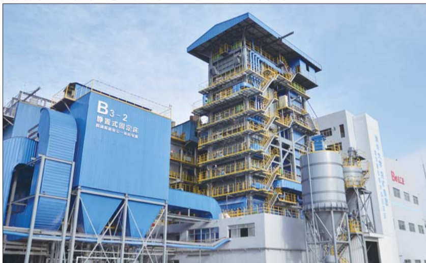
东滩电厂3#锅炉。
