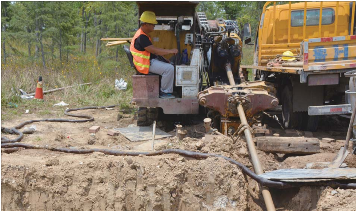
施工人员操作牵引拉管机,正在进行顶管作业。本报记者 孙璇 摄
