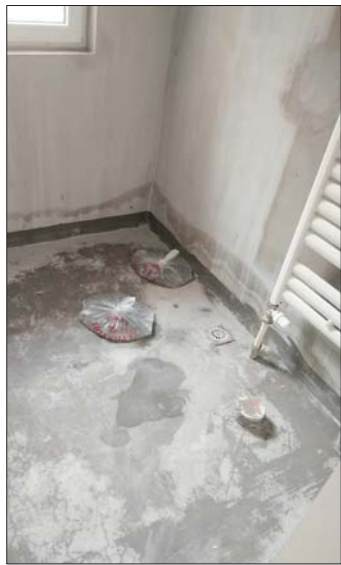
长清区联合云东府地产项目洗手间没有上水管。
