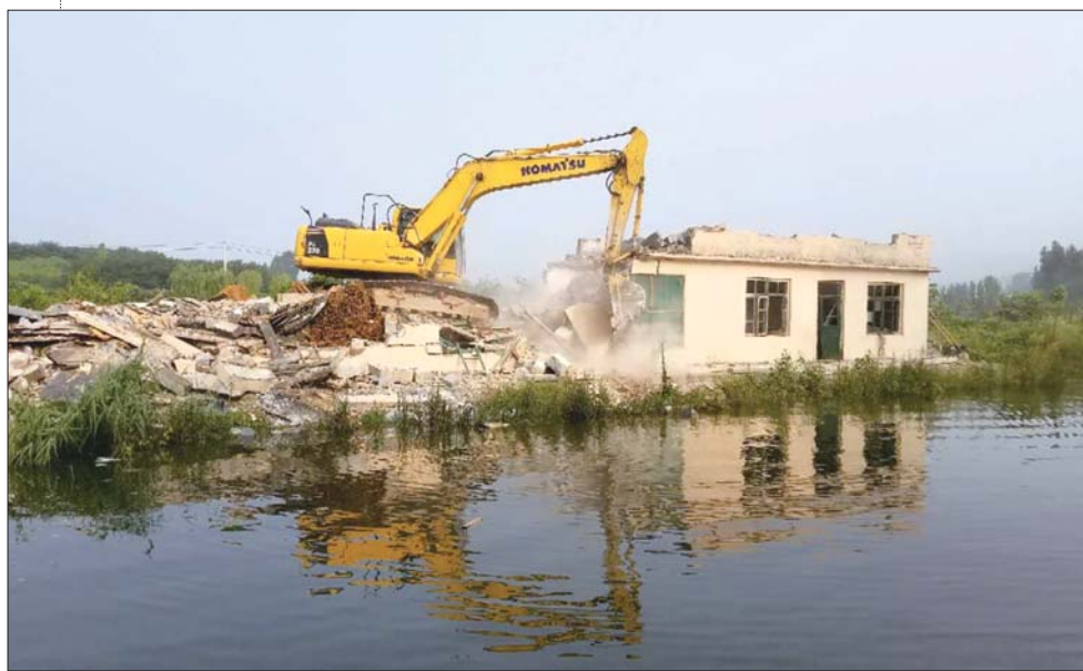
被拆除的违建就搭建在玉符河岸边。
