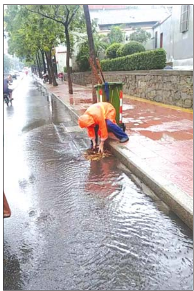
一环卫工人正在收集堵塞雨水算的树叶。
