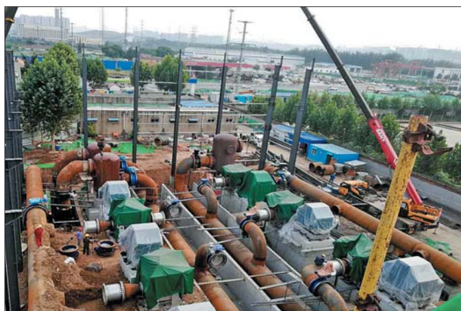
工业北路中继泵站本月底具备注水条件。 本报记者 张晓燕 摄
