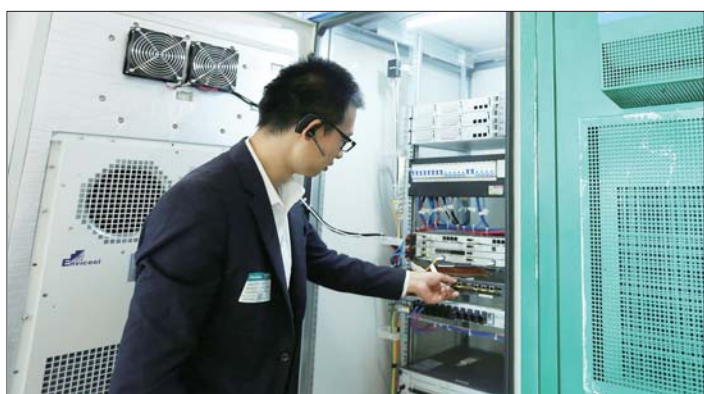
在青岛,工作人员正在调试新运行的5G基站。
