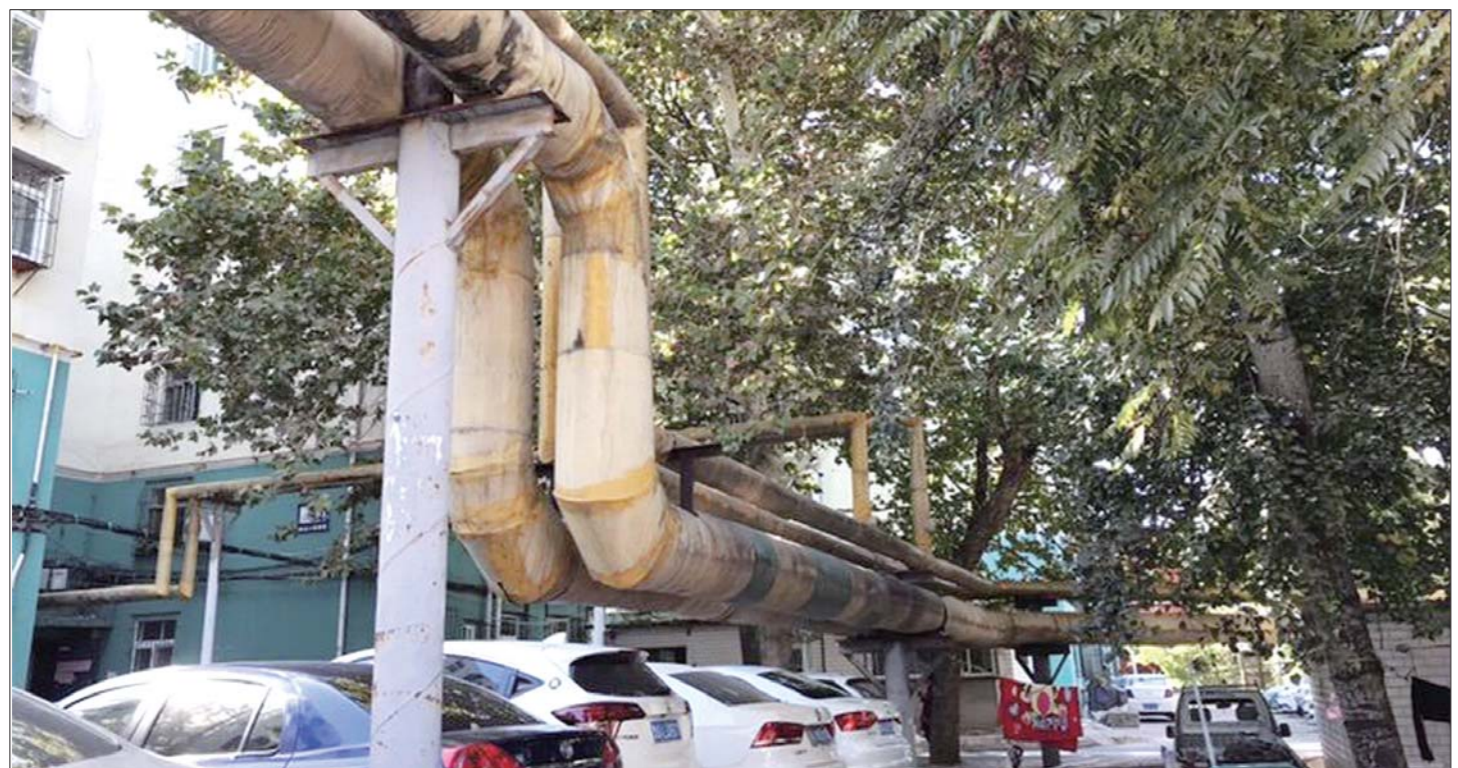
舜玉小区内老旧供暖管道。 本报记者 王杰 摄
