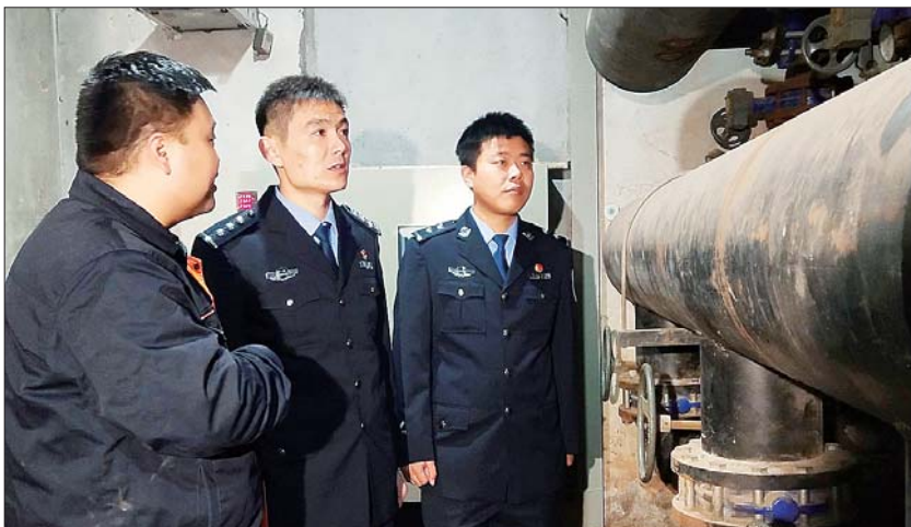
警企联合工作室的工作人员查看换热站运行情况。
