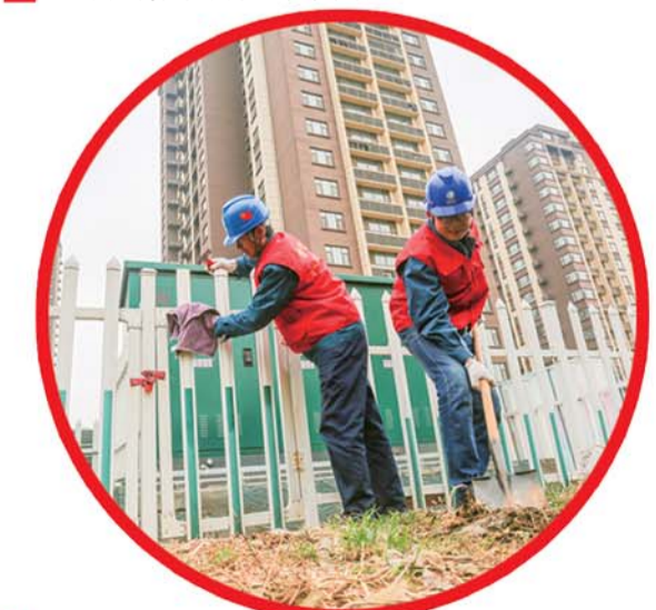
党员服务队队员清理电力环网柜设备。
