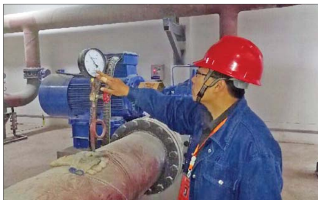
为了应对此次降温,东泰热力龙洞升压站提高流量。本报记者 张晓燕 摄
