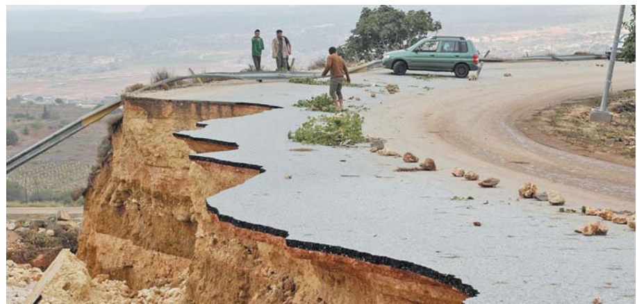
11日，利比亚一段公路被洪水侵蚀出现塌方。 新华/路透
