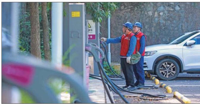
国网济南市历城区供电公司工作人员在九如山风景区停车场检查充电设备运行情况。冯立文 摄
