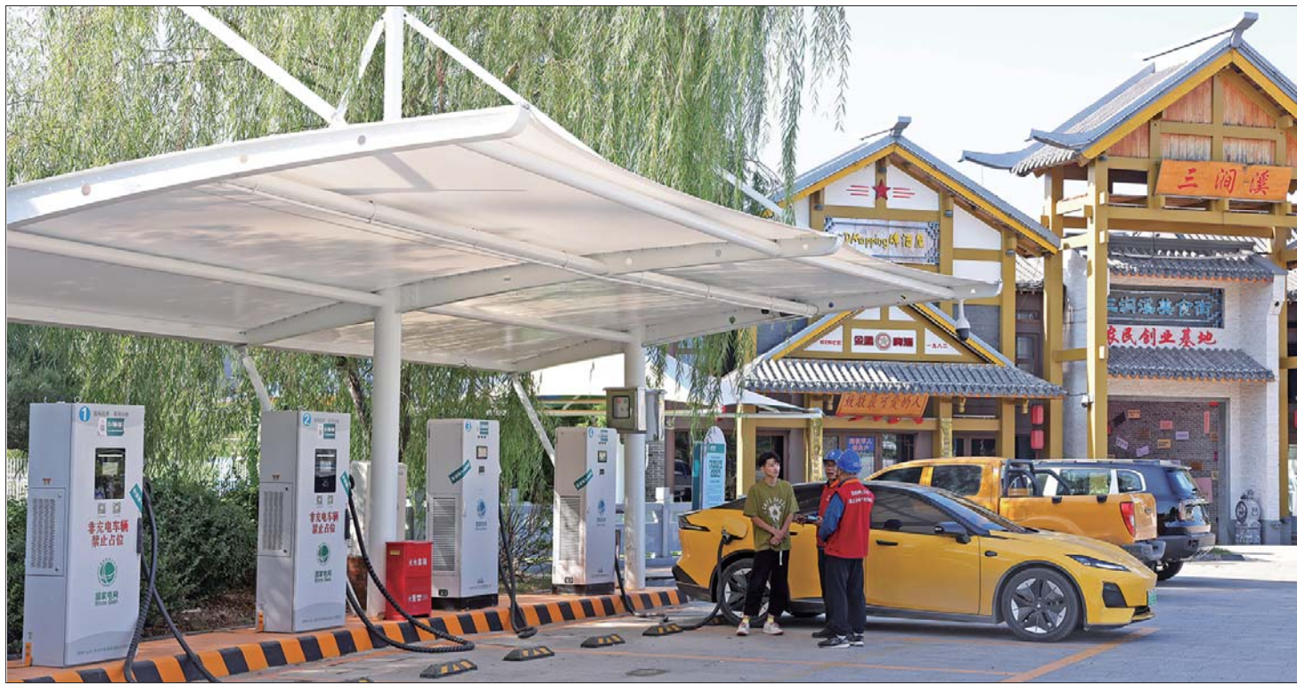
日前，在济南市章丘区三涧溪村美食街门口的电动汽车充电站，国网济南供电公司工作人员对站内充电桩设备开展了专项特巡，全力消除安全隐患，护航新能源汽车用户绿色出行。刘超 摄
