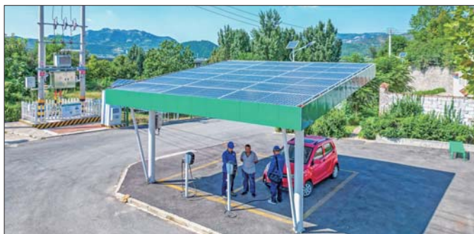
国网济南供电公司工作人员正在仲宫街道傅家峪村检查公用充电桩设备，保障村民充电需求。冯立文 摄
