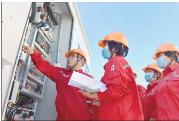
电力分公司组织职工在110千伏基南变电站对原标准进行交流诊断。
