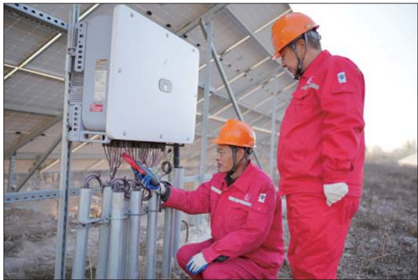
配电运维工按照新标准对低压配电线路进行全面巡视消缺。
