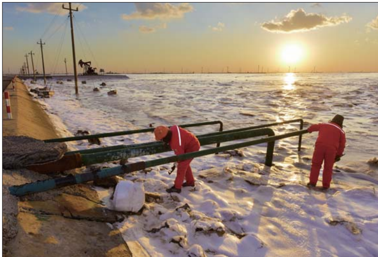
为保证油水井管线不被冰凌破坏，河口采油管理一区注采104站应急抢险突击队全天候加强巡护，确保寒潮期间安全平稳运行。
