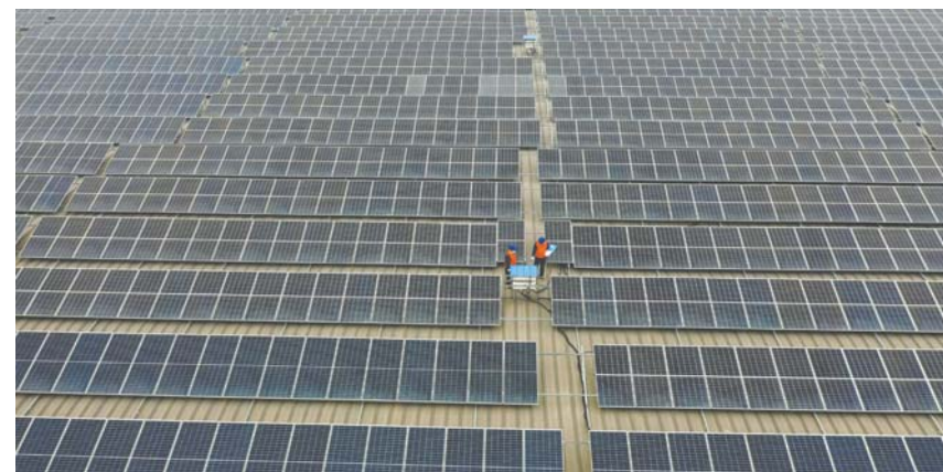
国网东营供电公司工作人员对辖区光伏发电项目运行情况进行巡视。(本报通讯员 韩文成 摄)
