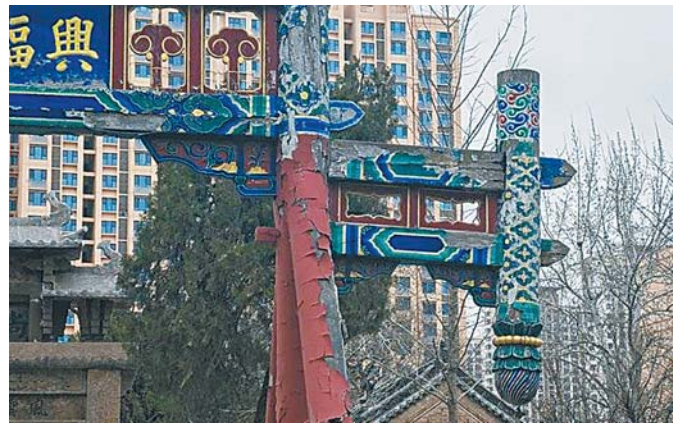
牌坊部分木质结构已脱落。
