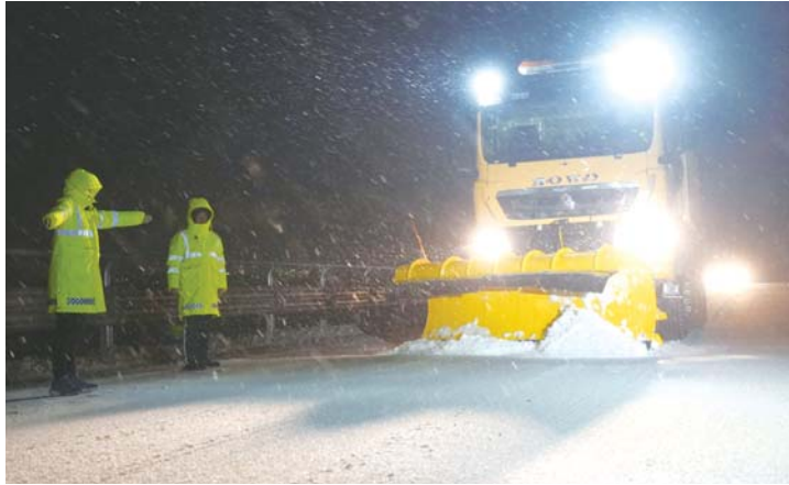
自20日下午4时起，济宁普降雪，截至晚间10时，城区积雪量超12厘米，山东高速济宁发展公司连夜展开除雪作业。图为济微高速(济宁段)除雪现场。记者 康岩 摄
